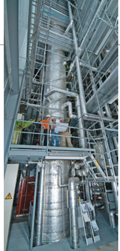
La cuve sous pression du réacteur PANDA. Institut Paul Scherrer, Suisse
