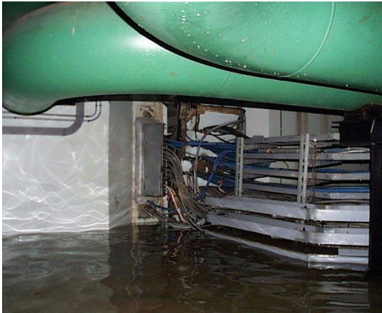
Bâtiment combustible Tranche 2 niveau - 8,50 m Local K 051 Trémie électrique envahie
