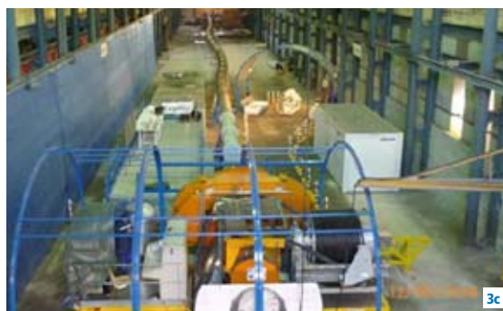
Fig. 3c: Récupération de colis de déchets HA depuis un modèle d'alvéole de stockage en France (programme ES-DRED, 2008)
